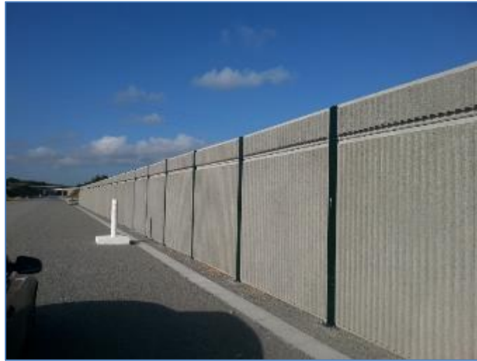
Figura 15. Ejemplo de pantalla acústica hormigón
